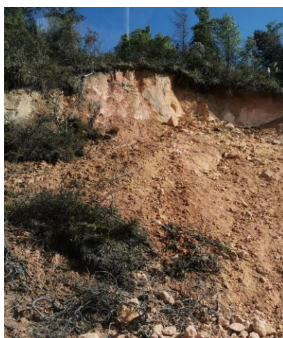
FOTOGRAFÍA 34. DESLIZAMIENTOS EN LA VÍA A SAN PABLO DE TENTA.
